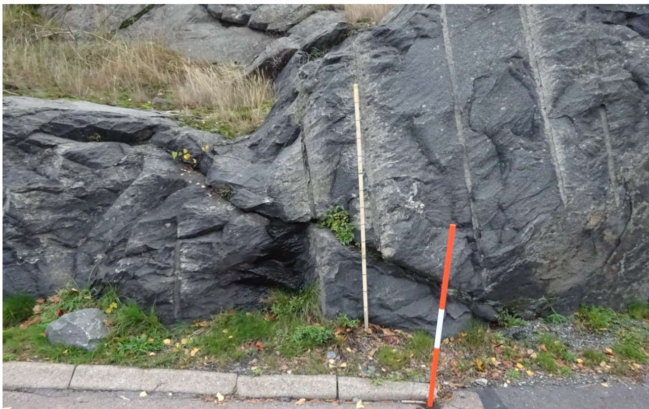
Bild 4 på ett mindre lokalt område där skrotning föreslås och borttagande av mindre block. Det verkar vara den vägen dagvattnet tar till vänster om stakkäppen (1,5 m hög). Situationen bedöms inte utgöra någon större risk så omgående åtgärd krävs inte. OMRÅDET HAR MARKERATS MED BENÄMNING Å1 PÅ PLANSKISSEN.
