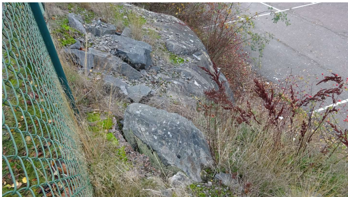
Bild 29 tagen på lösa block som fanns liggandes på bergytan just söder om GC-vägen. Ingen större risk men förslagsvis tas dessa bort för att undvika att dom flyttas ner av människor på området i söder. Noterbart är att framtida planerade infartsväg innebär att terrängen förändras och inga stabilitetsproblem uppstår då fyllning med slänt ner mot parkeringen projekteras.
