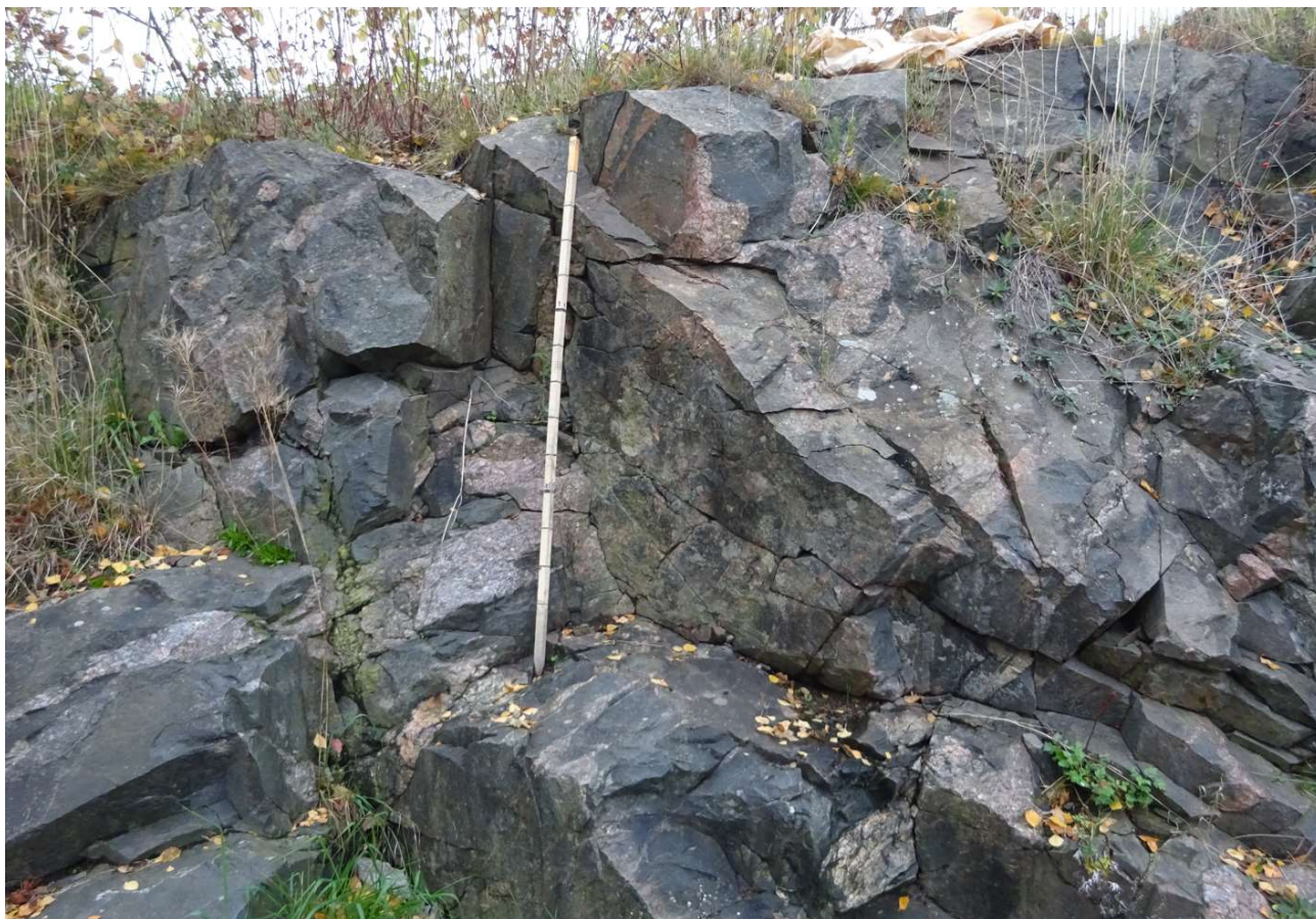
Bild 34 tagen på hörnet av parkeringen med berg med flackare lutning. Ingen rasrisk ner till parkeringsytan föreligger.
