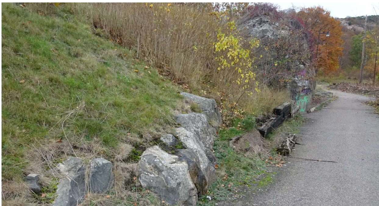
Bild 23 tagen mot öster (andra hållet) där bergskärningen övergår till jordslänt med relativt brant lutning närmast berget. Ingen åtgärd krävs i dagsläget. Noterbart är att ny infartsväg kommer att anläggas. Förslagsvis görs en mer detaljerad inmätning av lokala marknivåer vid projekteringen för att anpassa släntlutningarna.
